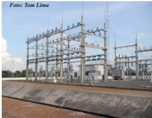
Subestação Uruçuí II
