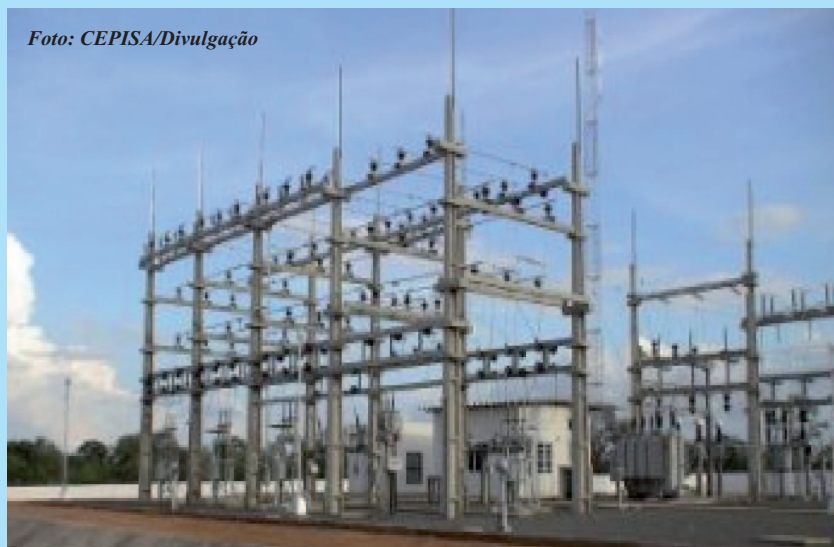
Subestação Uruçuí II
