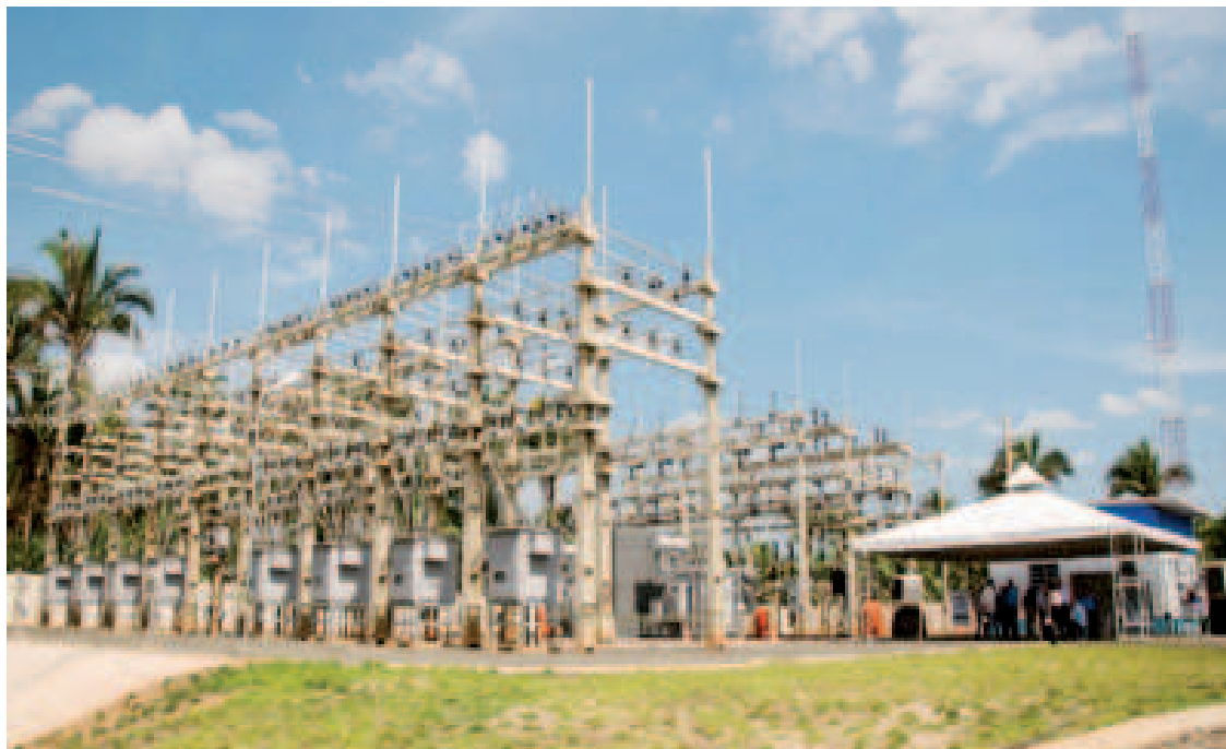
Subestação garante melhor fornecimento de energia (Foto:Regis Falcão)
