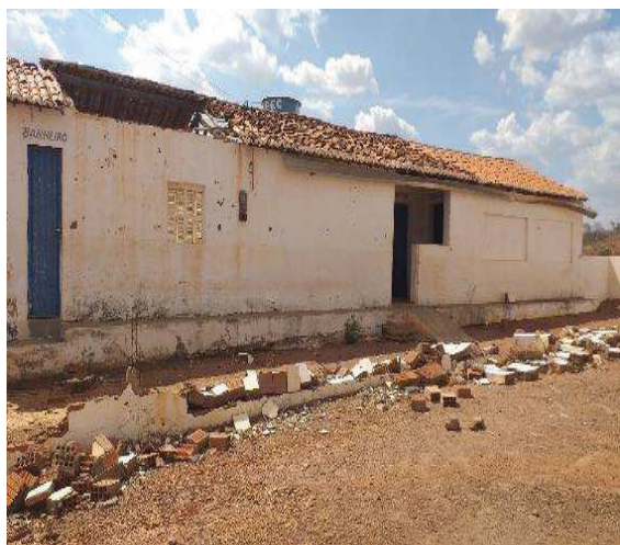
Figura 23 - Escola Municipal Joaquim Pinheiro Neto no Território Quilombola de Caraibas com o teto caído e fechada (Código INEP: 22090070)
